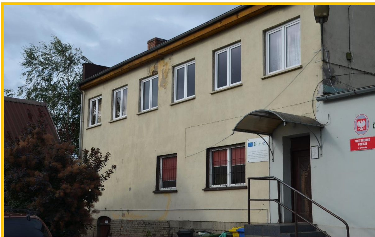
Rysunek 15 Przykład obiektów w złym stanie technicznym w Drawsku – budynek świetlicy wiejskiej Źródło: Materiały Gminy Drawsko
